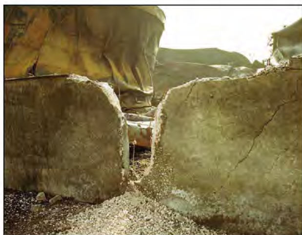
3. fénykép: Tűzeset során károsodott védőfal
